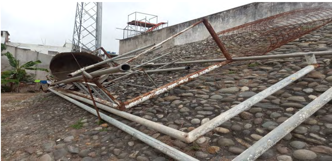
Materiales en proceso de oxidación fueron retirados y enviados a proceso de chatarrización.
