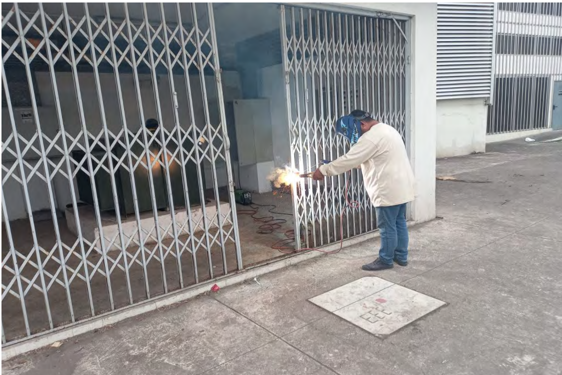
Reparación puerta metálica destruida por ladrones que intentaron ingresar al cuarto de Generado eléctrico Coliseo 3000.
