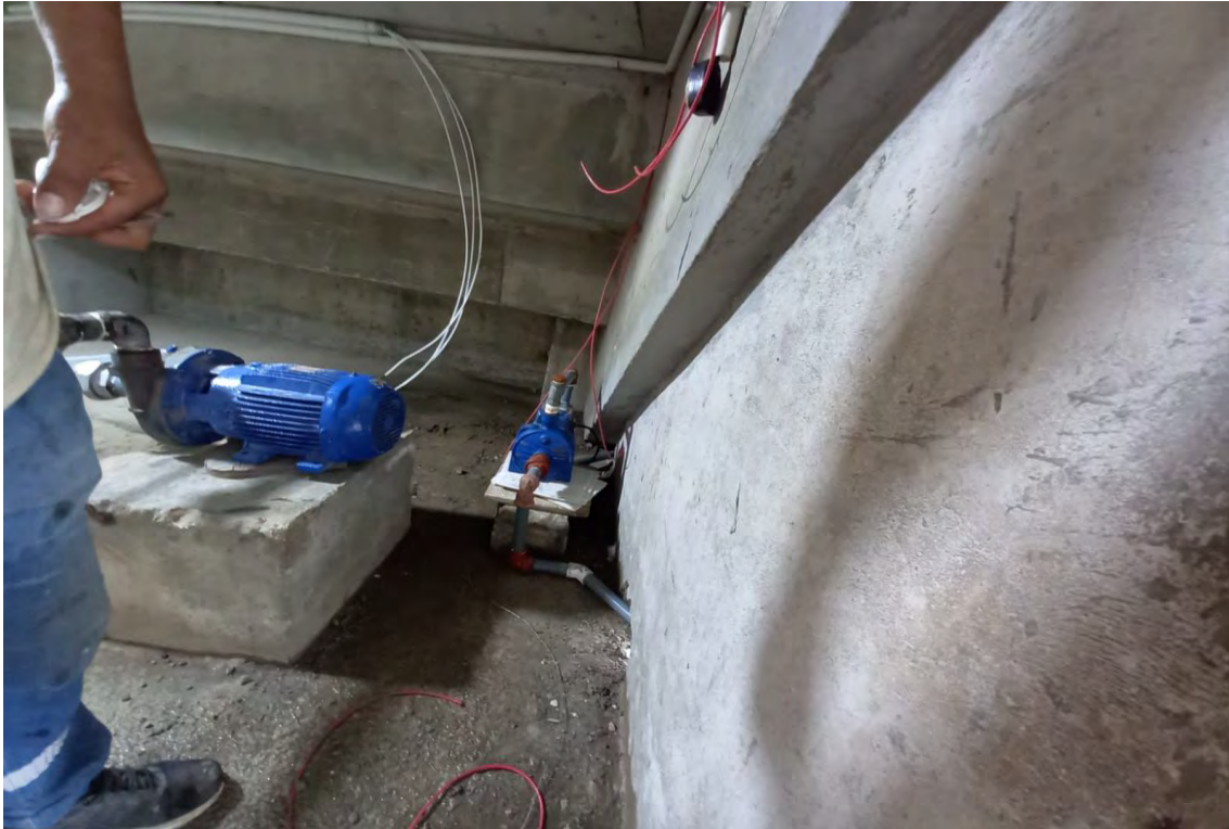
Personal de Fedeoro realizando trabajos de instalación tuberías interna y bomba de succión para nueva acometida agua potable Estadio 9 de Mayo.
