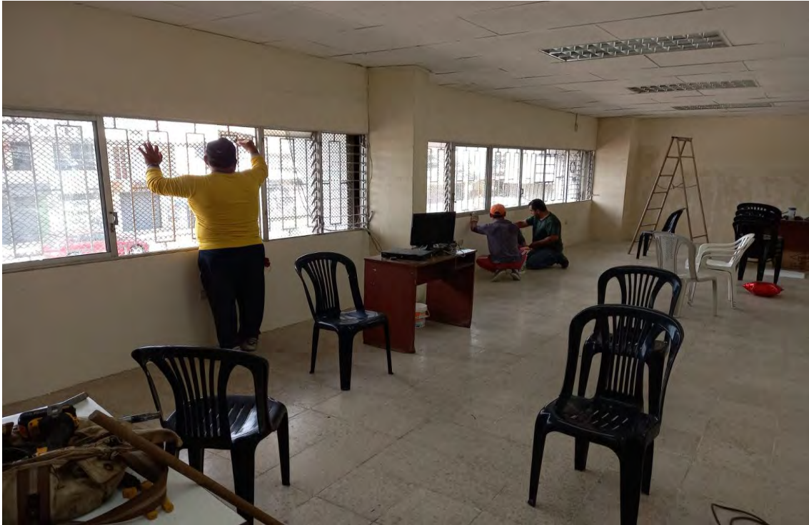
TRABAJOS DE REPARACIÓN PUERTA ACORDEON DONDE SE ENCUENTRA EL GENERADOR DEL COLISEO 3000. MARZO 2023
